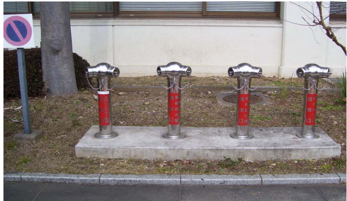
Hidran di setiap gedung
